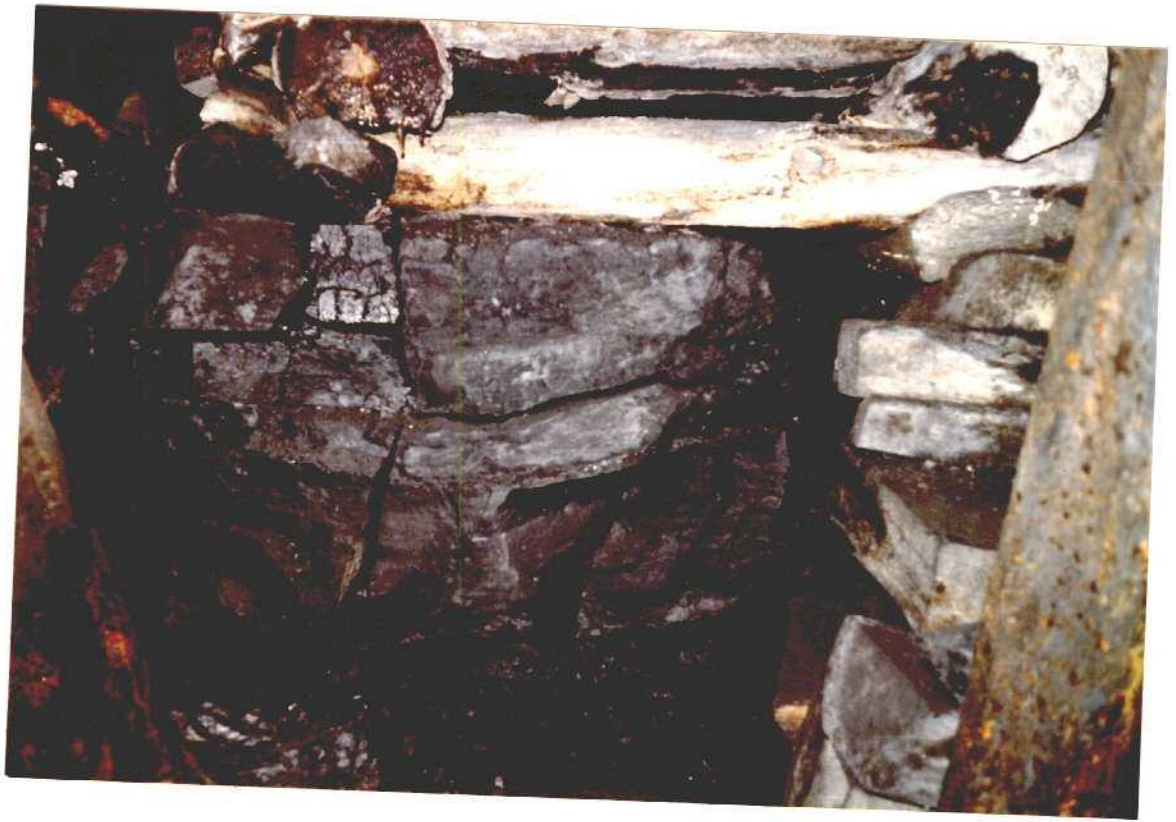
FRACTURACION DEL MURO DE LA CAPA.
