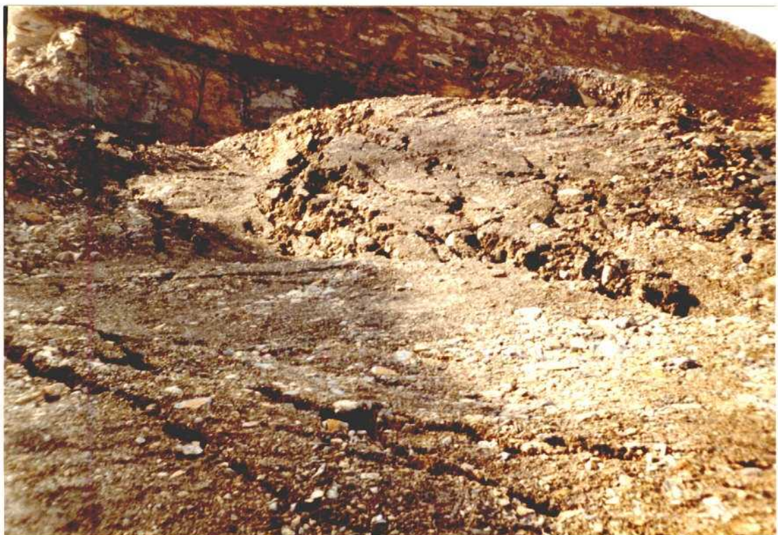
FOTO 2. TALUD 200. OBSERVACIONES: NOTESE LAS GRIETAS SUPERFICIALES DE LA ESCOMBRERA.
