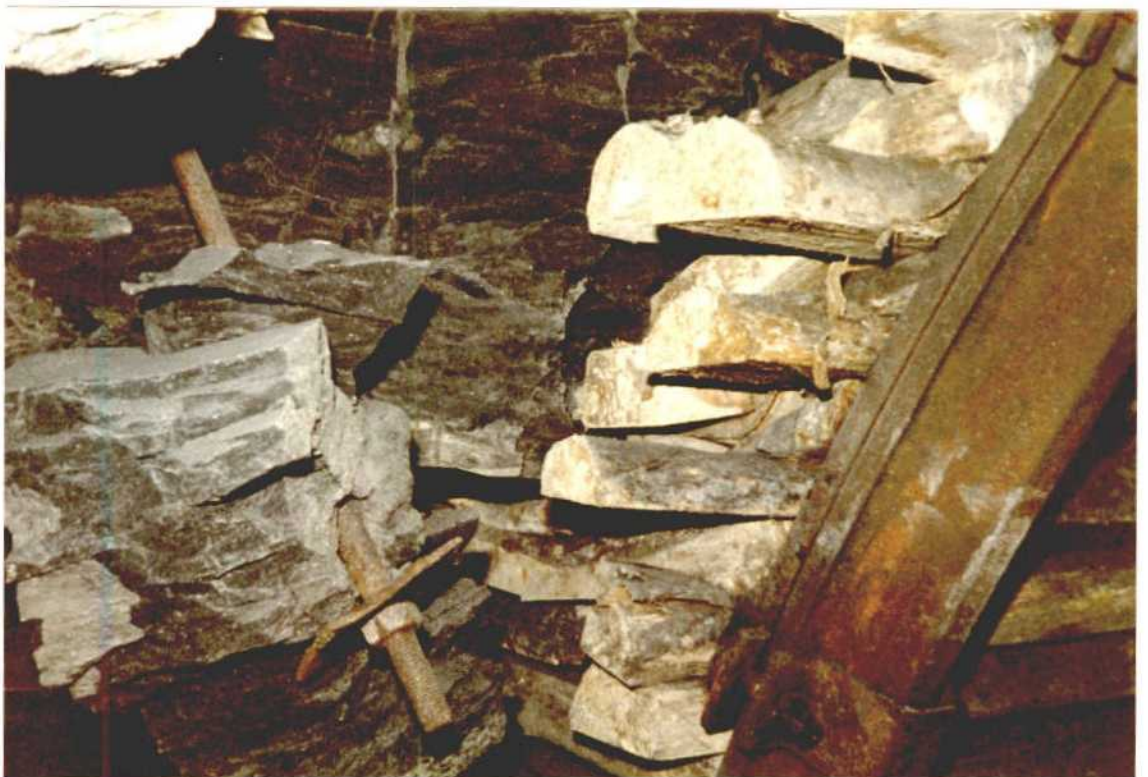
EN EL PROCESO DE ASIENTO DE LOS ESTRATOS, ALGUNOS BULONES SE DESPRENDEN.
