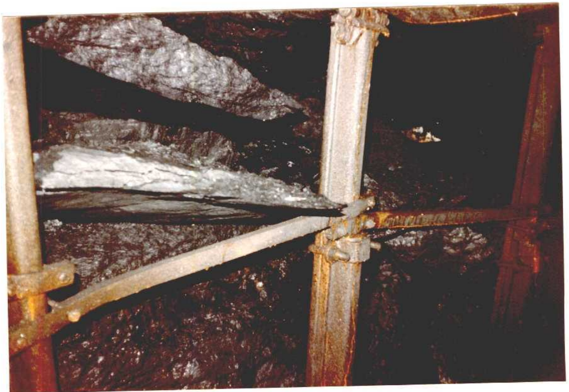
DESPEGUES DE LA PIZARRA DEL TECHO. OBSERVESE EL ARRIOSTRAMIENTO DE LOS CUADROS.
