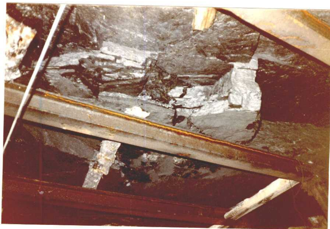
FRACTURACION DEL TECHO.
