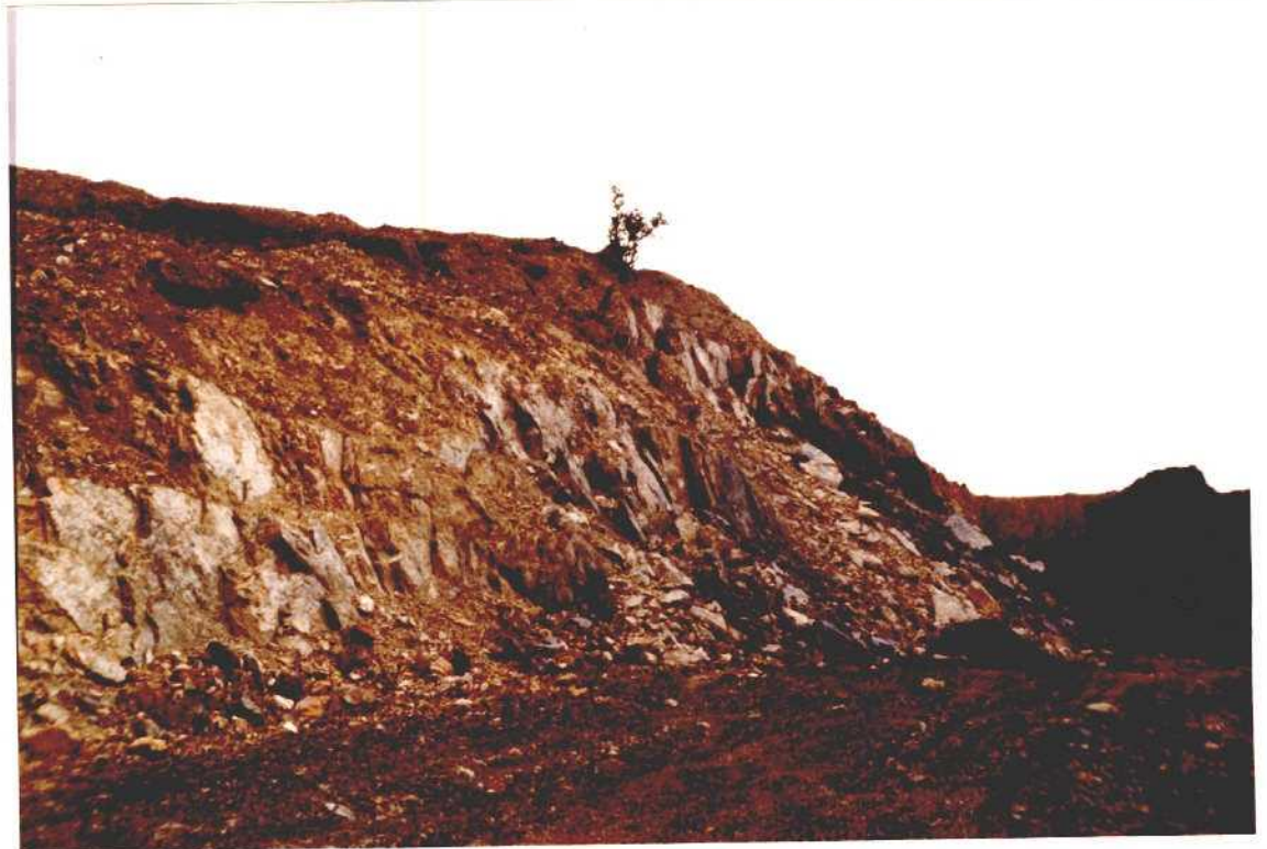
FOTO 2' TALUD 217. OBSERVACIONES: ESQUISTOSIDAD CON RIESGO DE VUELCO.
