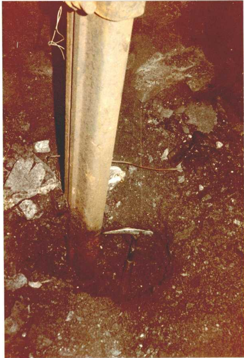
EMPOTRAMIENTO DE LA PATA DEL CUADRO.
