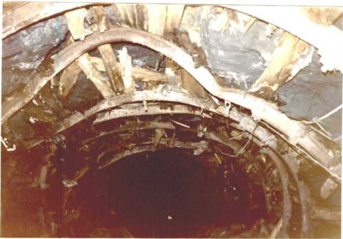
ASPECTO PARCIAL DE LA GALERIA. OBSERVESE LA DEFORMACION EN ESE CUADRO.
