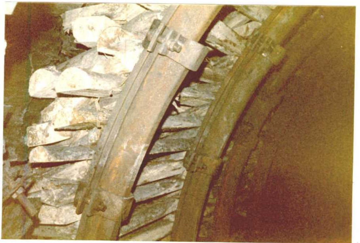
REVESTIMIENTO DEL CUADRO.
