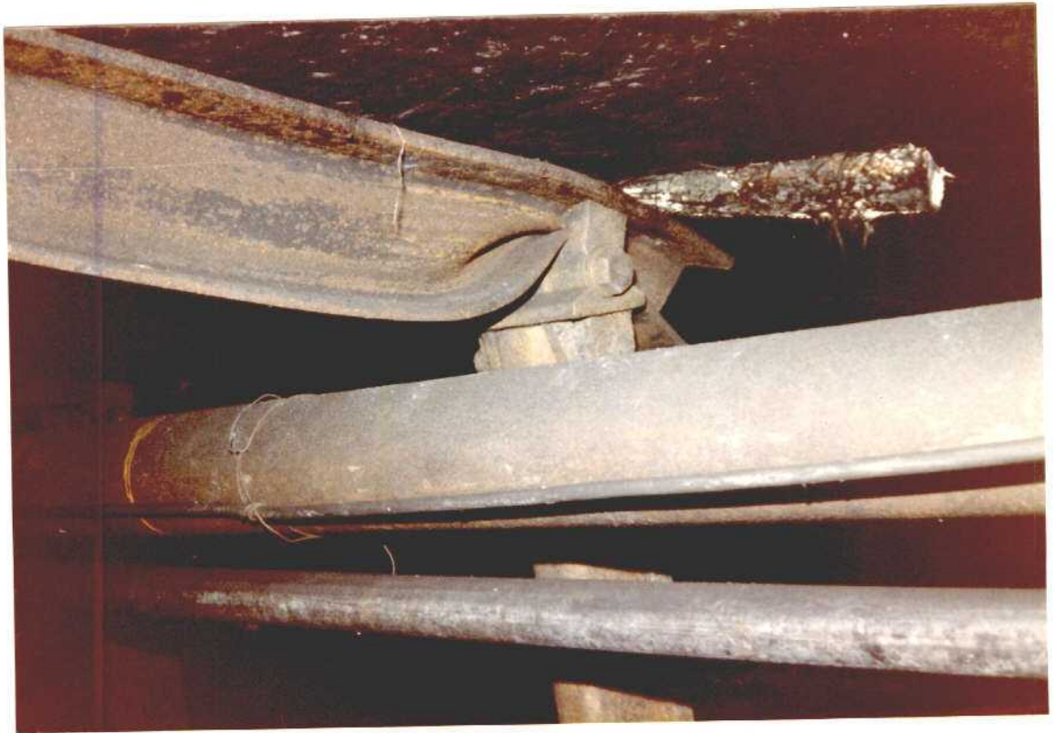
DEFORMACION EN LA UNION DEL DINTEL CON LA PATA.
